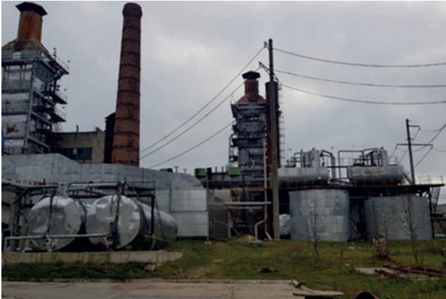
Теплоелектроцентрально у місті Новий Розділ Львівської області
